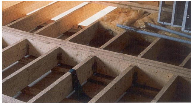
Obr. 2.47 Kvůli tepelné ochraně v místě stropu nad vnějším prostředím se celý prostor mezi stropnicemi vyplní tepelnou izolací [1]
